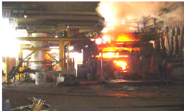
Fig. 12 Horno eléctrico de arco
