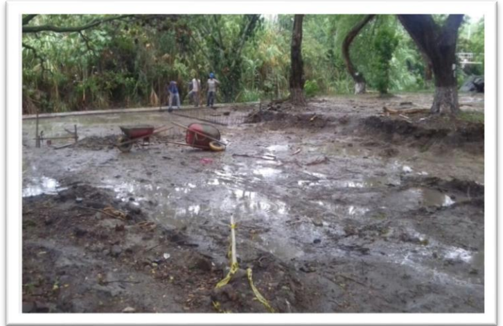
Figura 25. presencia de lodo e inundaciones por lluvias
