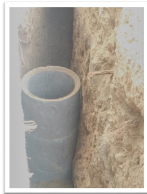
Figura 50. cámara de inspección
