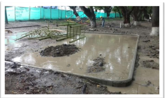
Figura 28. presencia de lodo e inundaciones por lluvias
